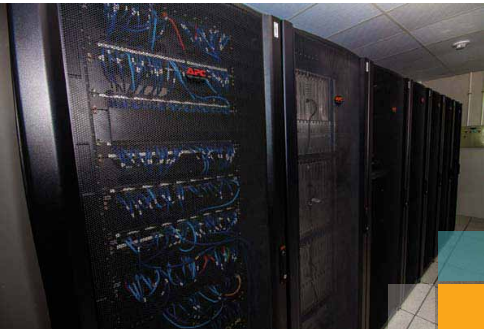
Novas instalações do Data Center
